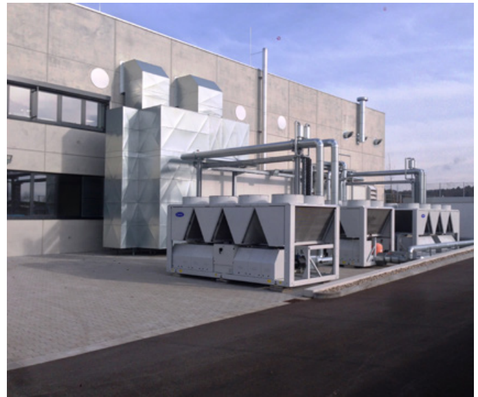
Abb 2: Technik zum Betrieb von Reinräumen muß energieeffizient geplant werden.
