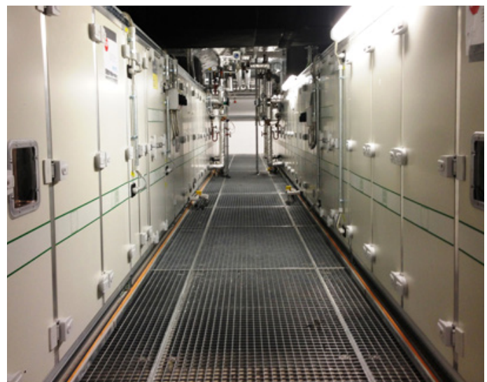
Abb.4: Beim Einsatz der RLT-Anlagen sollte auf sog. „Life-Cycle Cost“ Betrachtung Wert gelegt werden.
